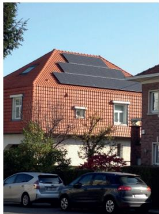
Panneaux photovoltaïques visibles depuis la rue
